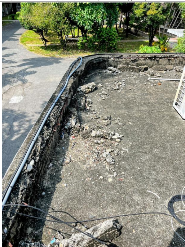
屋頂層防水損壞嚴重
