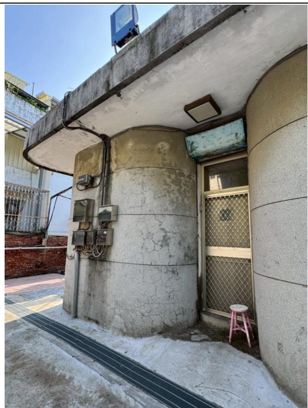
既有管線老舊且外露
