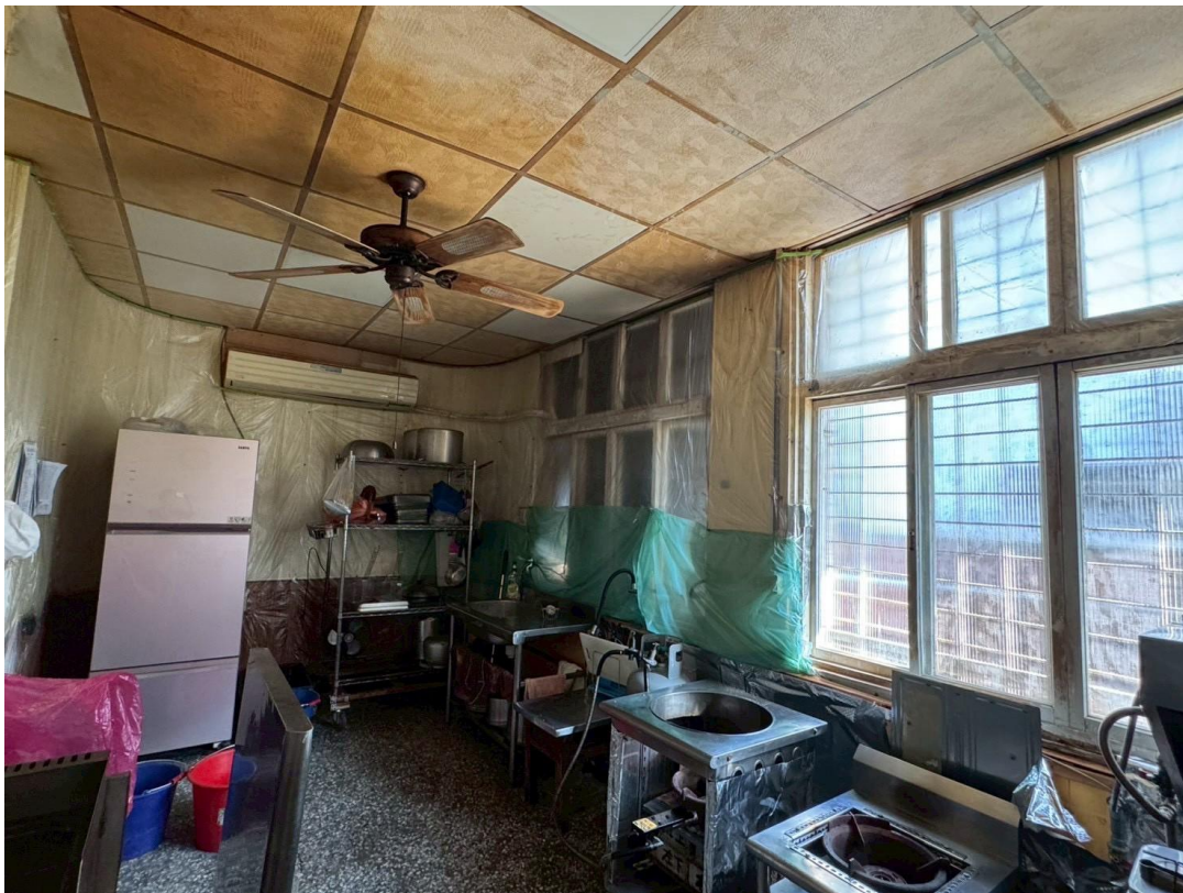
內部空間老舊，天花板狀況差
