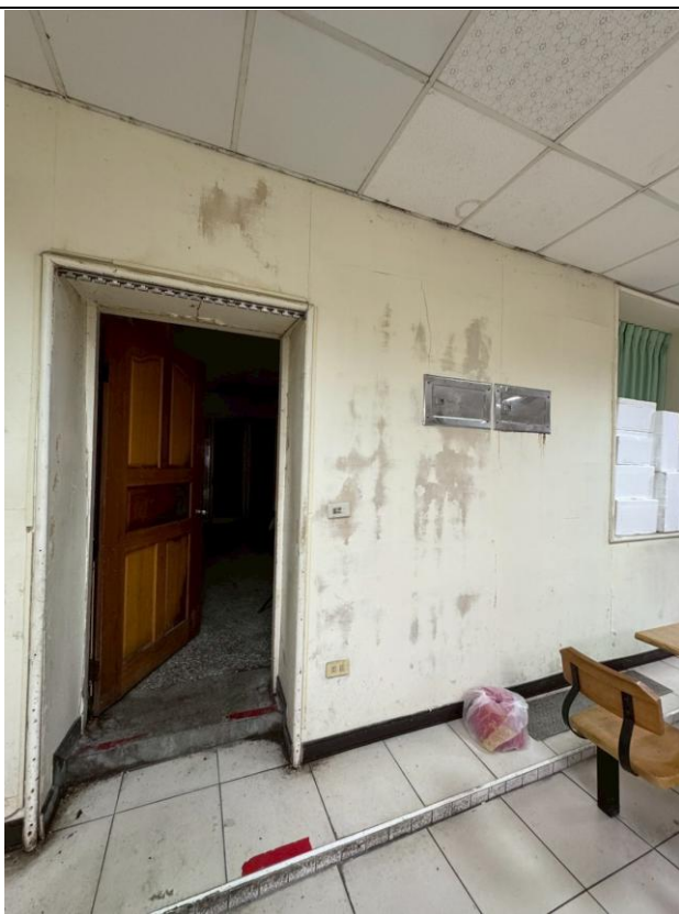
內部空間老舊，牆體出現裂痕
