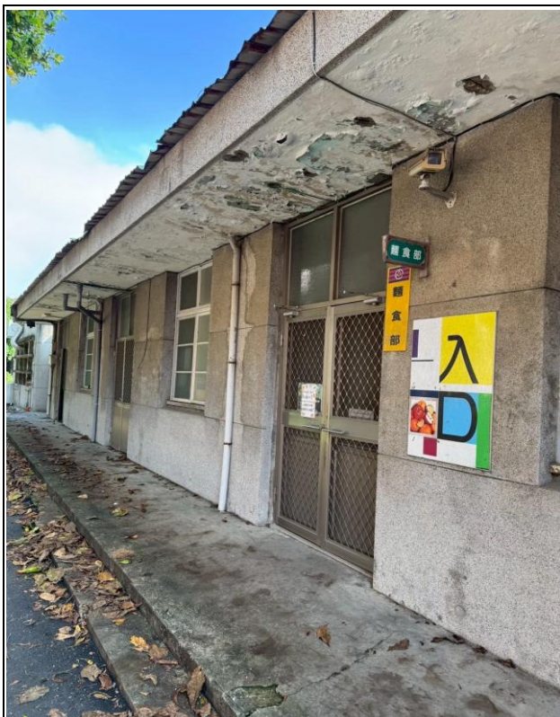
天花部分嚴重壁癌，部分鋼筋裸露
