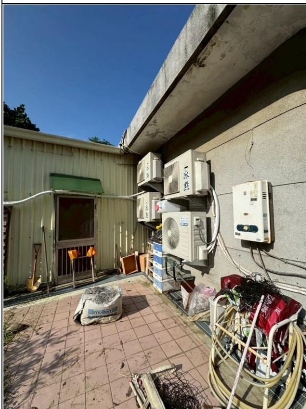
既有管線老舊且外露
