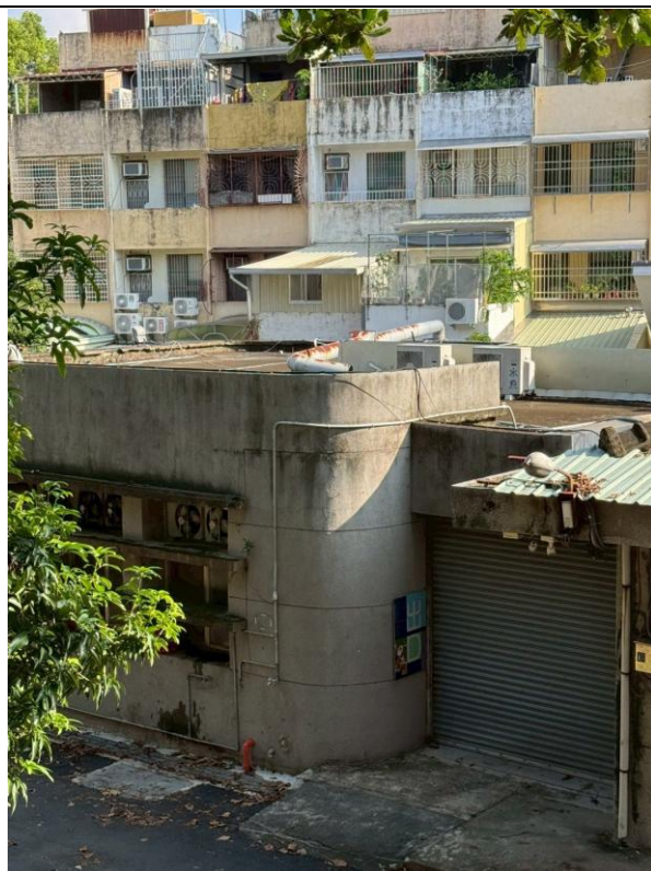
屋頂層管線老舊危險
