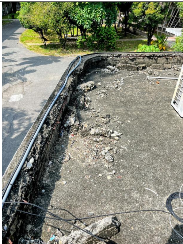
屋頂層防水損壞嚴重
