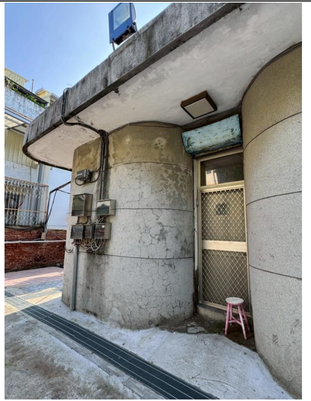
既有管線老舊且外露
