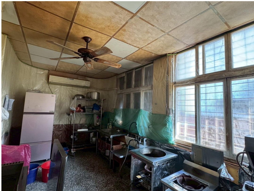
內部空間老舊，天花板狀況差
