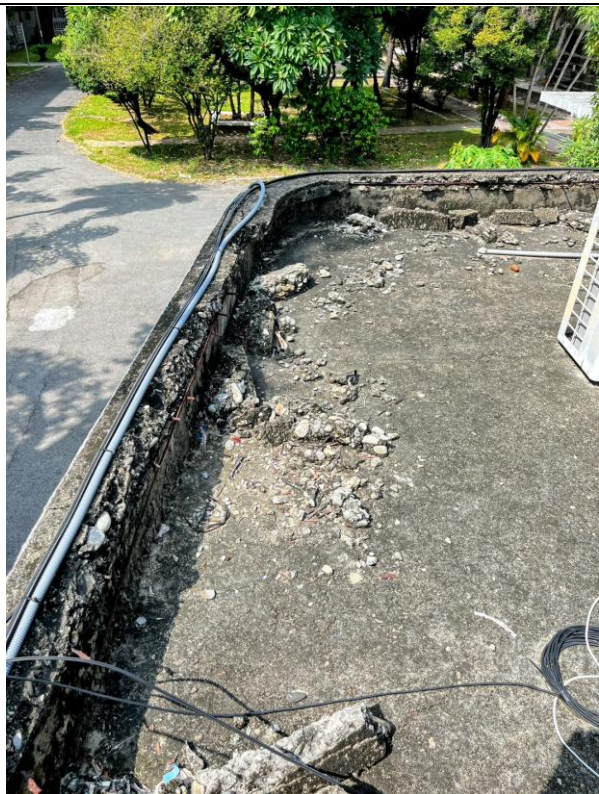
屋頂層防水損壞嚴重
