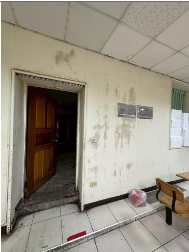
內部空間老舊，牆體出現裂痕
