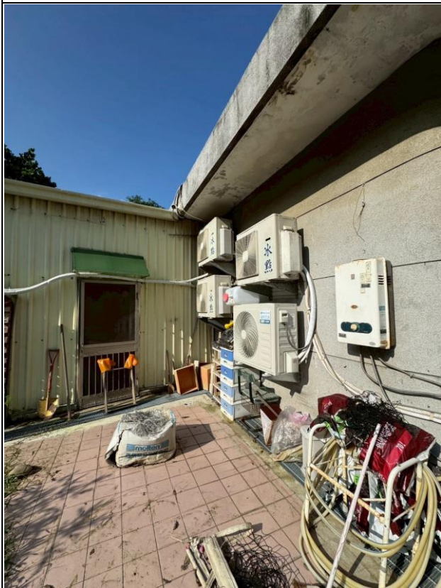
既有管線老舊且外露
