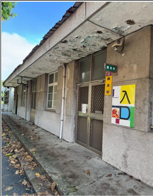
天花部分嚴重壁癌，部分鋼筋裸露
