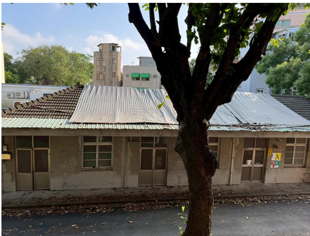
屋頂層漏水狀況嚴重，需以帆布蓋上避免內部漏水導致用電用火危險
