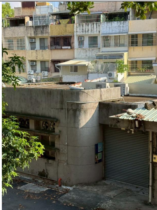
屋頂層管線老舊危險
