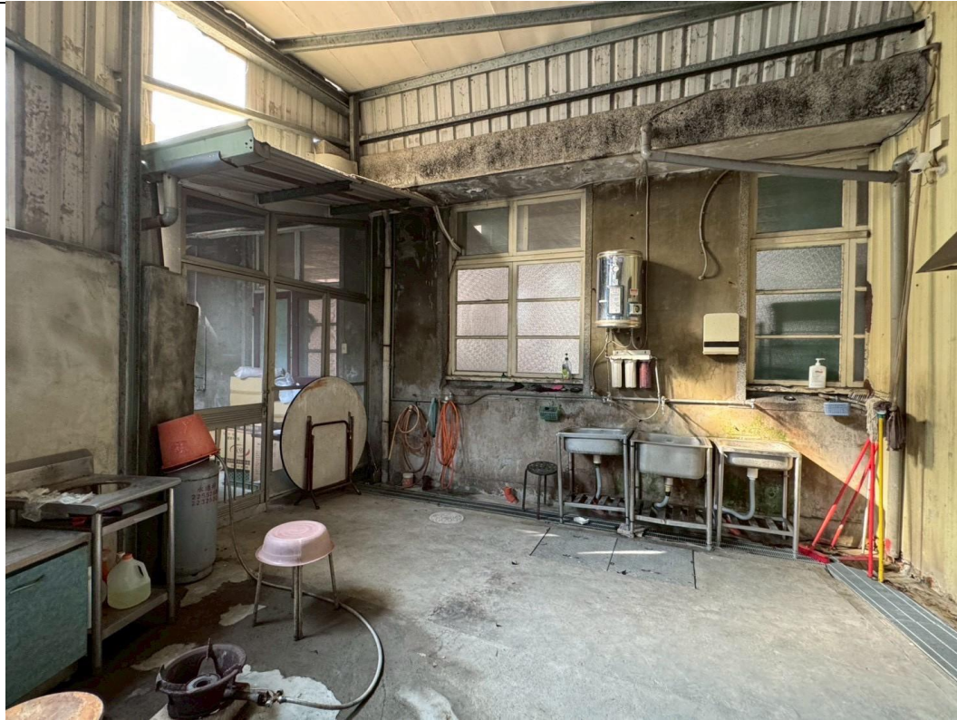
內部空間不足，以鐵皮加蓋增加使用空間，具危險性
